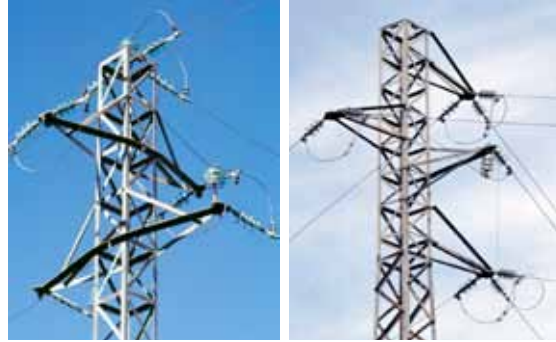
Fotografías 35 y 36. Apoyo de derivación con riesgo muy elevado de electrocución para las aves antes (izquierda) y después de su corrección (derecha). Fotos: Albert Tintó.
