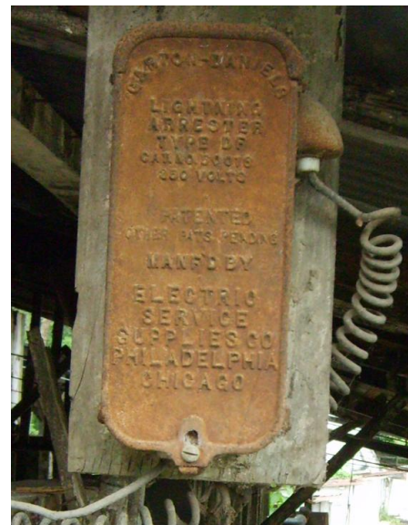
Figura 9. Caja de pararrayos con poco estado de deterioro.
