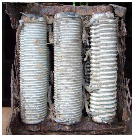
Figura 7. Vista posterior Reóstato.
