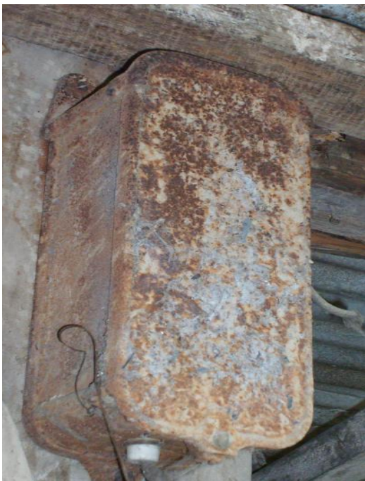
Figura 8. Caja de pararrayos con gran estado de deterioro.
