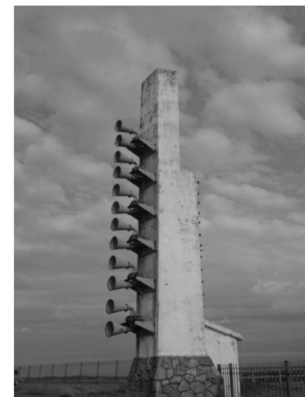
FIGURA 4. Sistema de sirenas del faro del Cabo Peñas (Asturias). | Figure 4. Siren system of the Cabo de Peñas lighthouse (Asturias).
