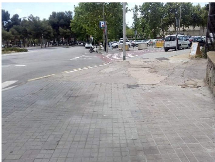
Figura 10. Paviment en mal estat a la cantonada entre el carrer Menéndez Pelayo i l'Av. Joan XXIII, a l'entrada del bar de la Facultat de Farmàcia.
