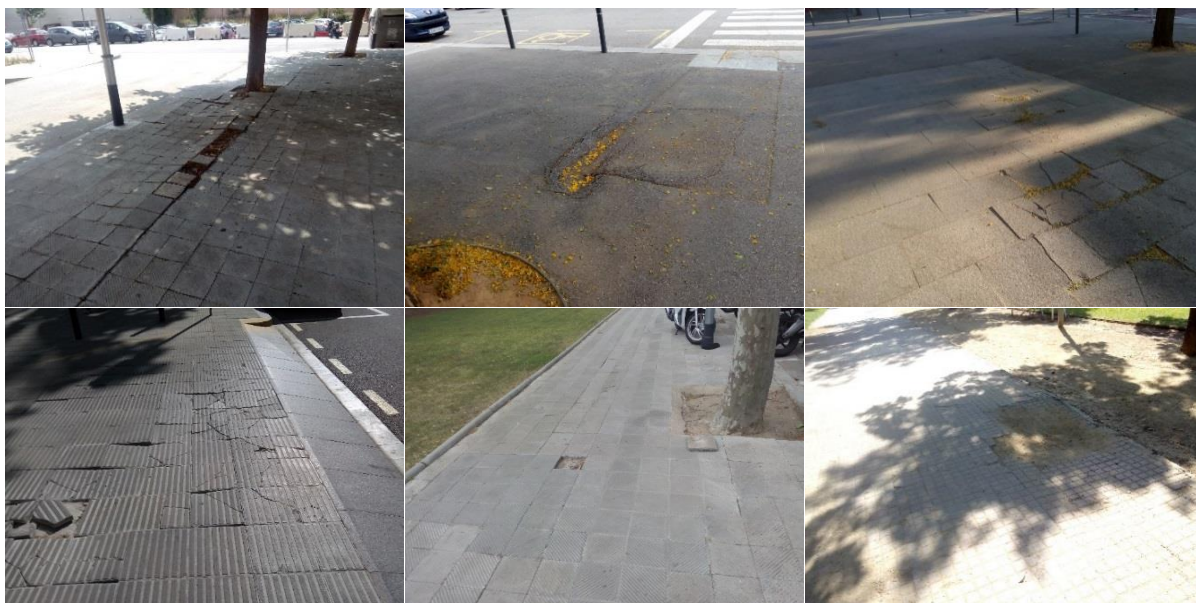
Figura 9. Exemples de paviment en mal estat: carrer Menéndez Pelayo (superior esquerra), carrer d'Adolf Florensa (superior centre i dreta), carrer Pau Gargallo (inferior esquerra i centre) i Av. Diagonal (dreta).
