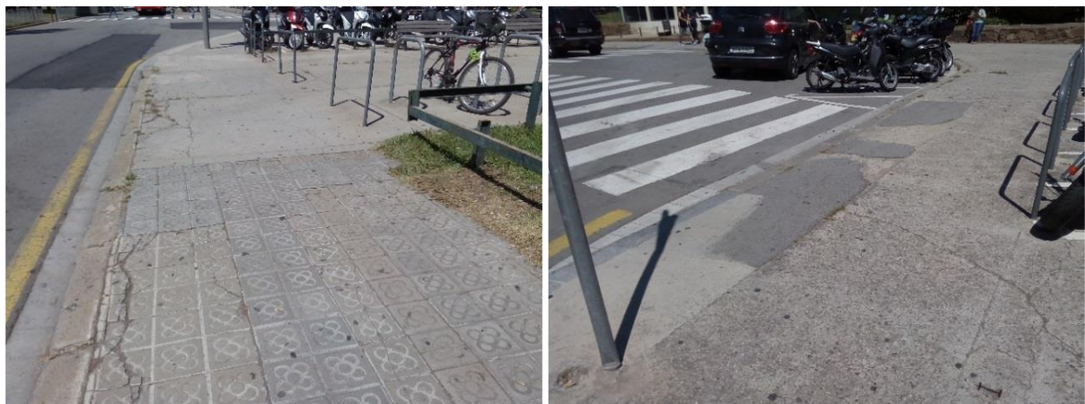
Figura 2. Exemple de paviment en mal estat (esquerra) i rebaix de vorera en mal estat i sense complir la normativa (dreta).
