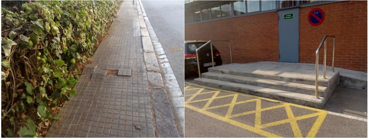
Figura 40. Paviment irregular sobre vorera (esquerra) i barrera arquitectònica permanent (dreta).
