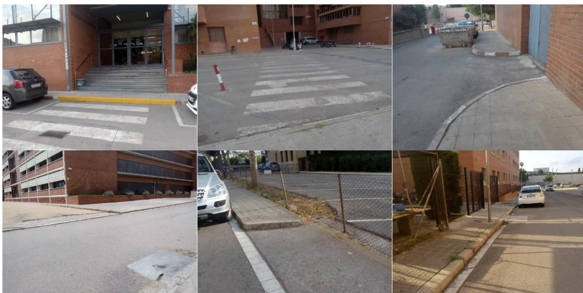
Figura 39. Manca de rebaixos a la vorera o que no compleixen la normativa: davant de la porta d'entrada a la Facultat de Geologia (superior esquerra), a Biologia (superior centre), porta d'accés al magatzem de residus de Geologia (superior esquerra), i vial entre Biologia i Farmàcia (inferior).
