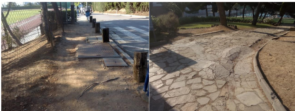
Figura 31. Pavimentació de la vorera en mal estat.
