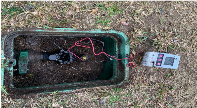
Programador de reg de l'àrea de l'edifici d'oficines connectat a l'electrovàlvula.
