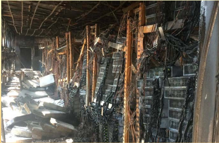
Octubre 2014. Incendio del datacenter de Bitcoin, en Tailandia
